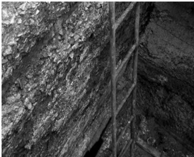
Рис. 1. Разрушение обделки смотровой шахты под действием коррозии (проектная толщина 500 мм, после удаления коррозии 285 мм)
